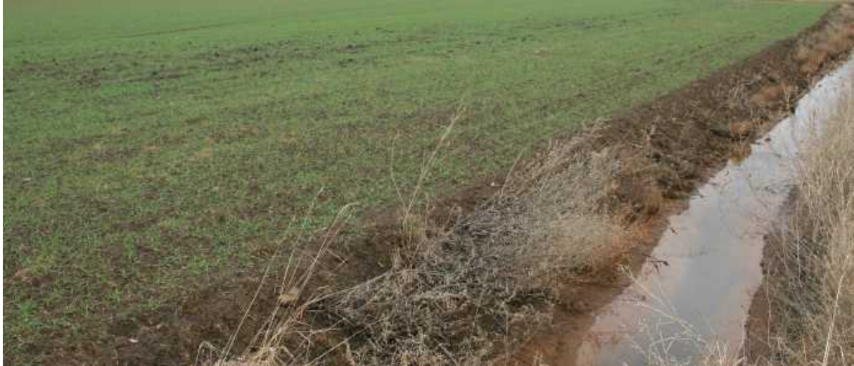
Abb. 6: Der Acker der Vorhabenfläche wird bis zur Uferkante der Sulze bewirtschaftet, es fehlt somit ein Ufersaum.
